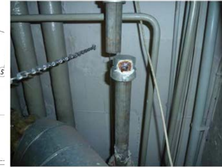
Korrosion an nicht zurückgebauter Trinkwasserleitung
