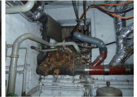
Versorgungsleitungen in Technikzentrale, A-Trakt
