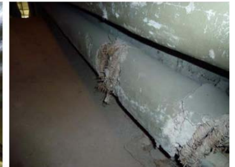
Beschädigte Dämmung an Trinkwasserleitung, Installationskeller
